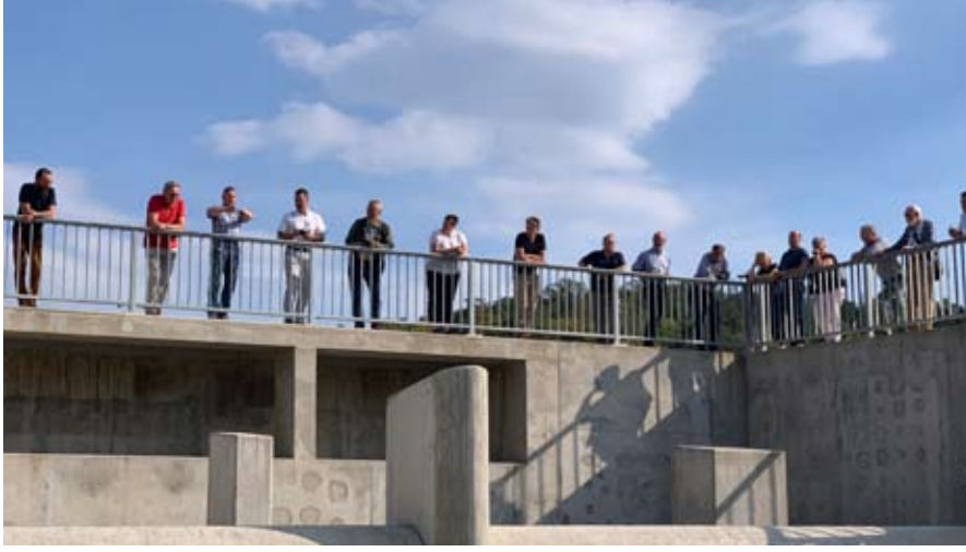
Wippra, 23.09.2020: Teilnehmer des Selke-Dialogs informierten sich über den Baufortschritt des Rückhalte- beckens.
